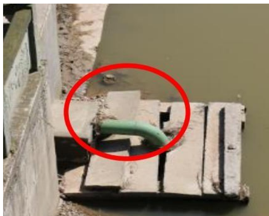
(4) 取水泵的进水口
